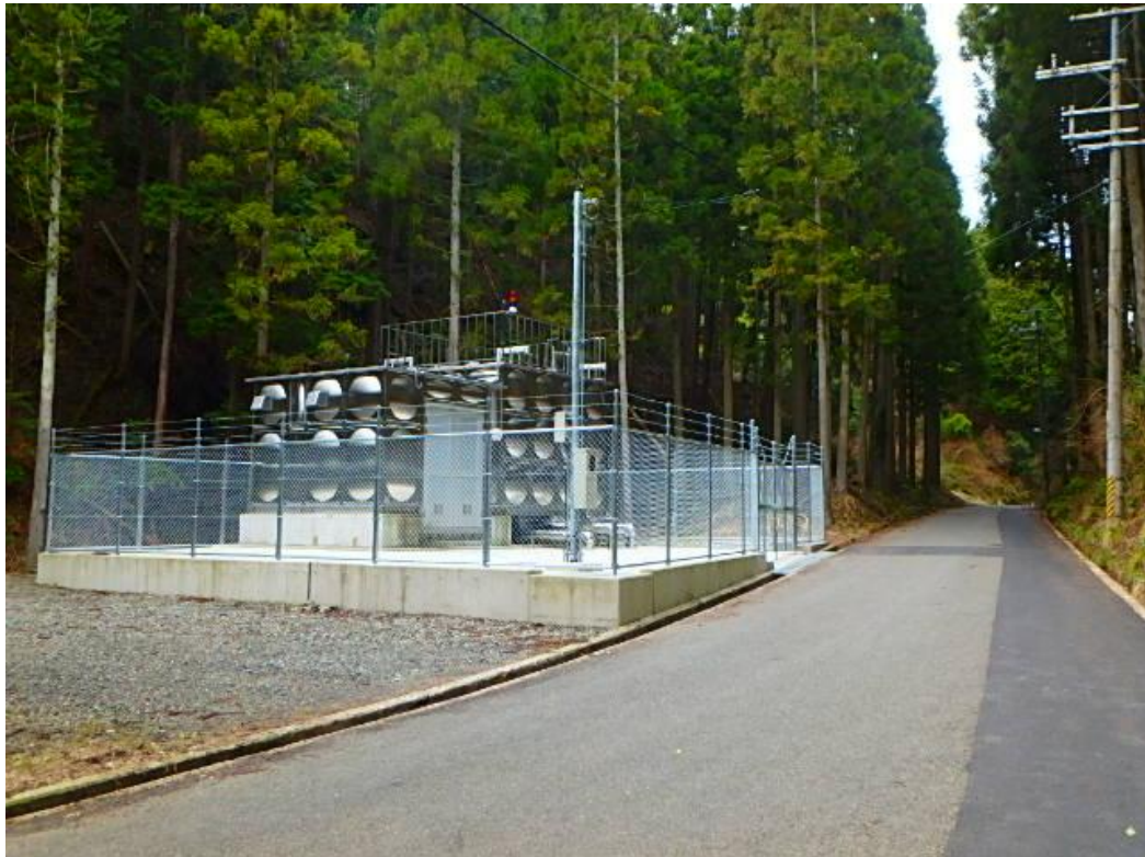
岡田中簡易水道長谷配水池
